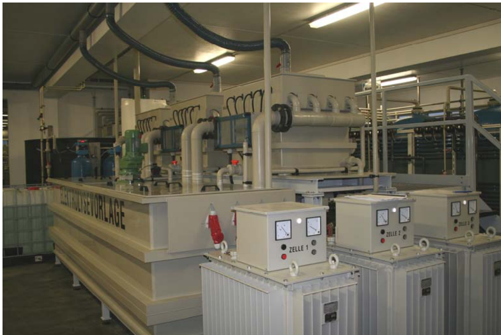
Die neue Anlagentechnik bei der Jörg Schiffer GmbH & Co. KG: Rechts im Hintergrund die Ionenaustauscher, die Gewinnungselektrolyse mit drei ungeteilten Zellen im Vordergrund.
